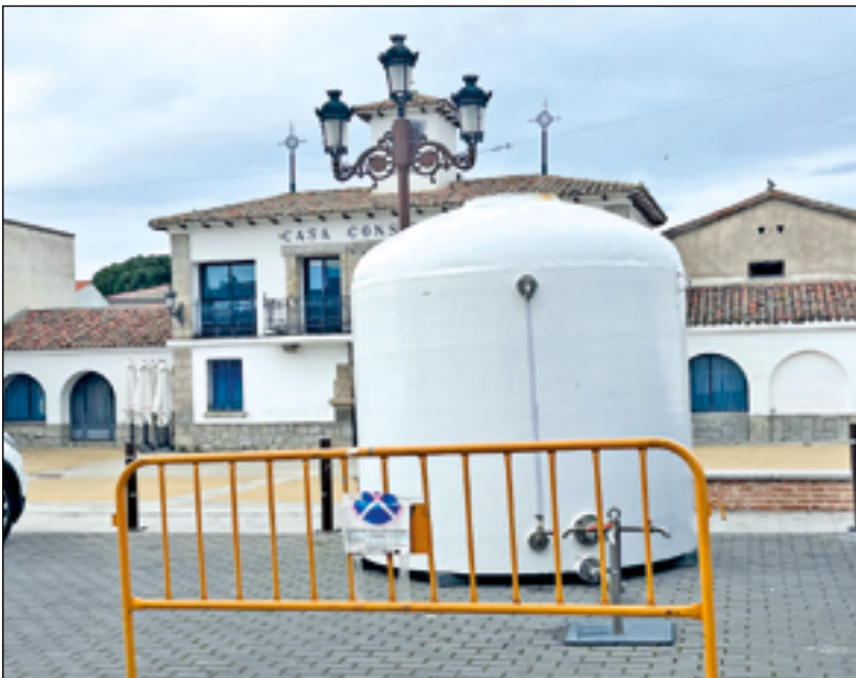
Depósito de agua potable instalado en la Plaza del Ayuntamiento.
